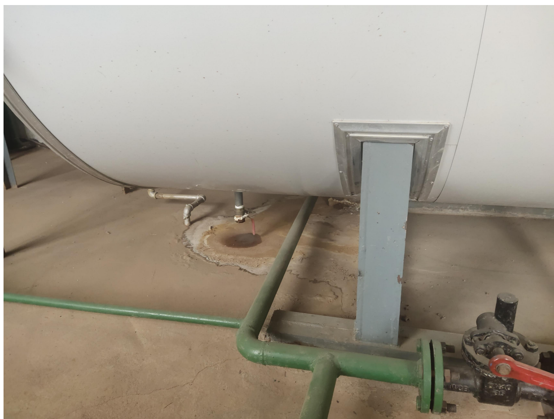
锅炉排污管网
