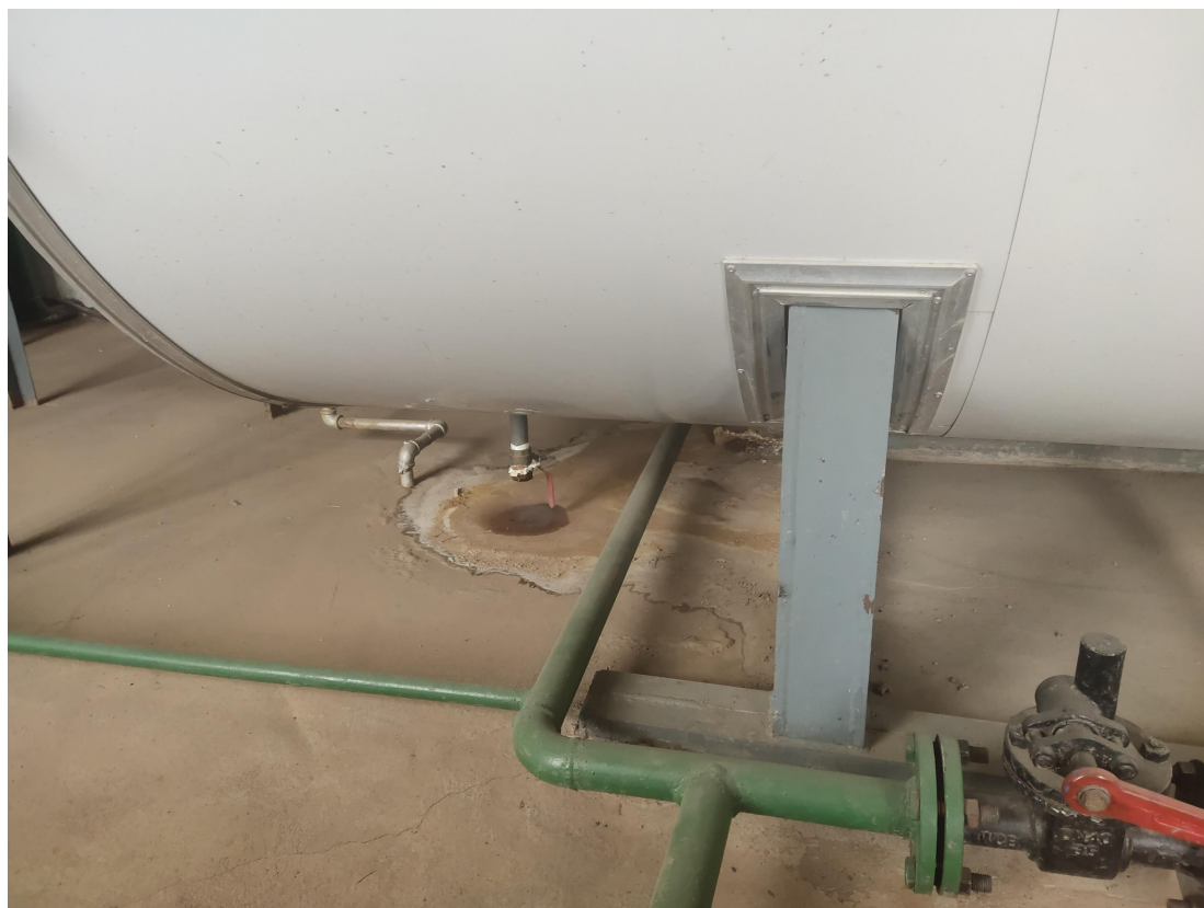
锅炉排污管网
